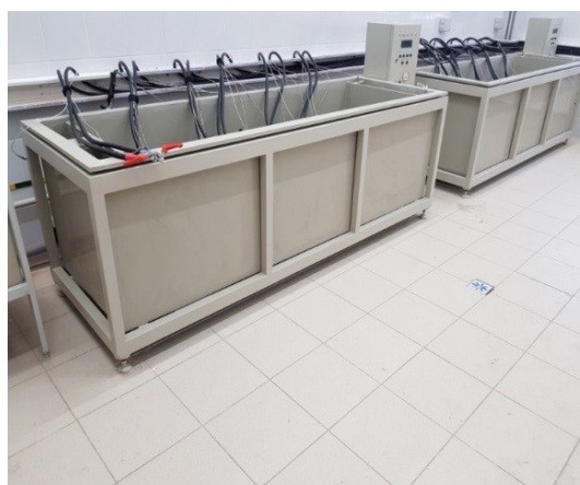
Фото №9 Лаборатория. Ванны для испытания АКБ (Исток)
